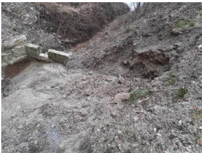
Figure 4: Affaissement de la rive droite au niveau du dépotoir le 3 mars 2021
