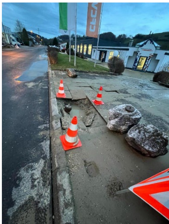
Les dégâts causés par la fuite du 4 janvier au Grand Pré
