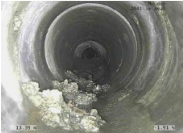
Fortes dégradations du revêtement
