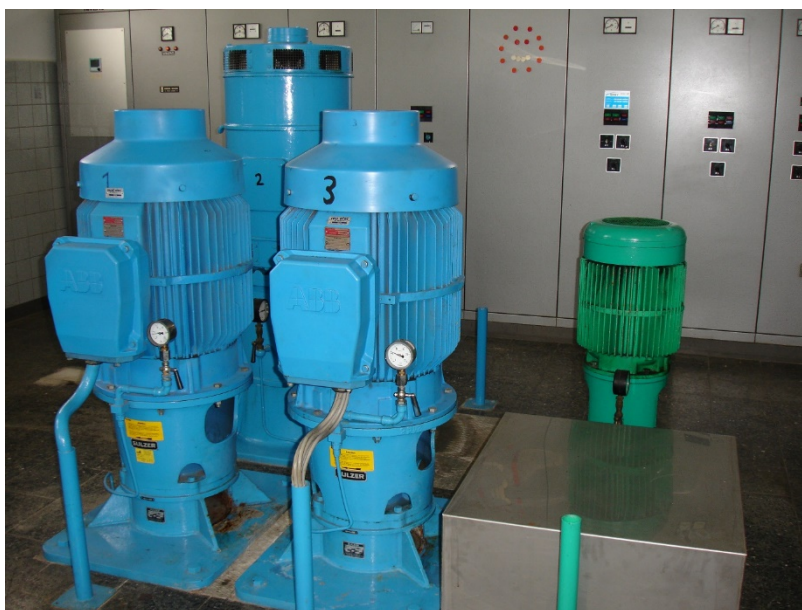
Le groupe des 5 pompes (Illustration ancienne, la pompe verte a été remplacée en 2020)
