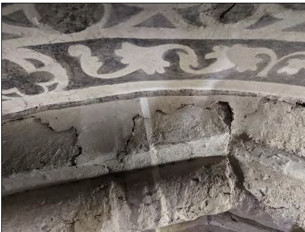
Figure 3 : perte d'adhésion de l'enduit et des joints de l'arc en molasse.
