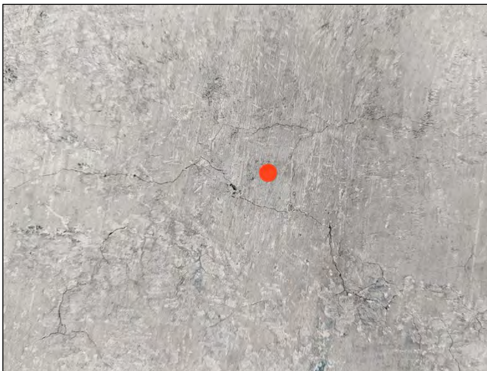
Figure 4 : perte d'adhésion entre l'enduit de finition par endroits extrêmement fin (1-2 mm) et l'enduit de fond. Ces soulèvements sont souvent accompagnés de microfissures qui rendent des portions d'enduit importantes très fragile.
