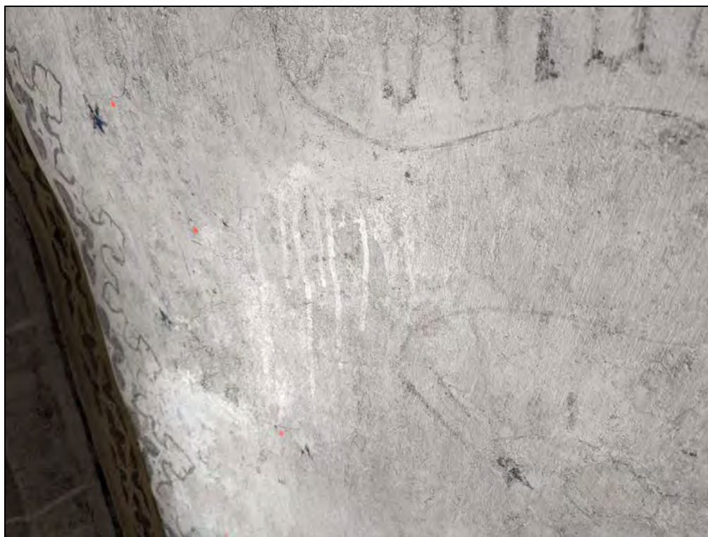
Figure 8 : coulures du fixatif utilisé pour le refixage de la couche picturale lors de la restauration des décors peints en 1974. L'ensemble du voûtain a un aspect brillant en raison de l'application en excès de ce produit.
