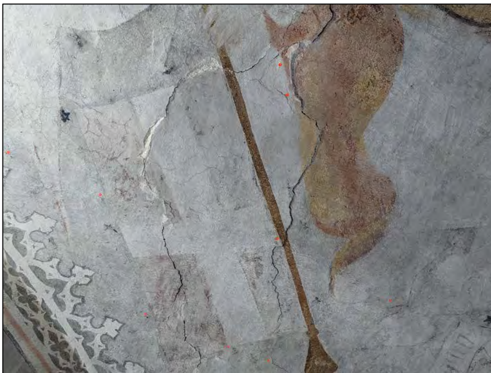
Figure 1 : fissures profondes et lacunes de l'enduit, stabilisées provisoirement par des colmatages.
