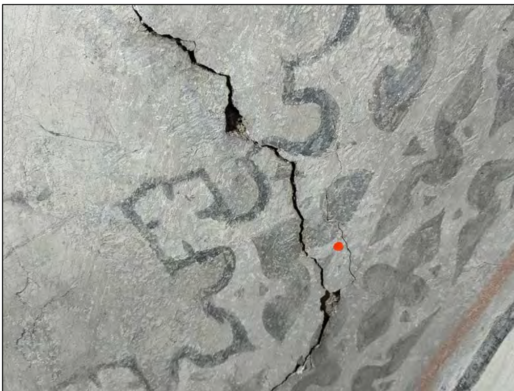
Figure 2 : fissures et lacunes de l'enduit. Une portion d'enduit se détache entre les fissures et risque de chuter si elle n'est pas stabilisée.
