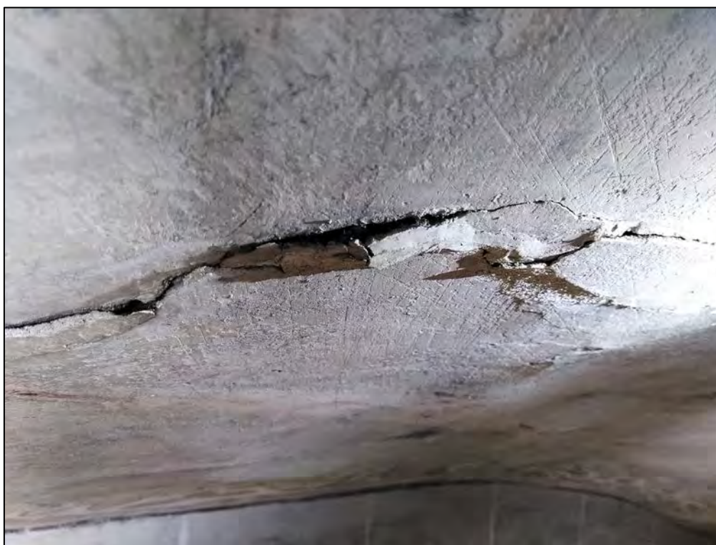
Figure 5 : soulèvement de l'enduit avec quelques pertes déjà observées.
