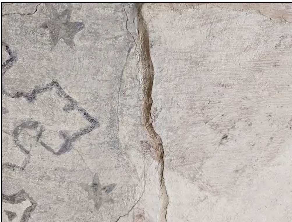
Figure 7 : traces d'outils ayant servi à la mise au jour des décors peints. La couche picturale ainsi que l'enduit de finition ont été endommagés.
