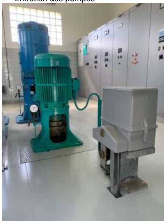
Système de pompage © Moudon
